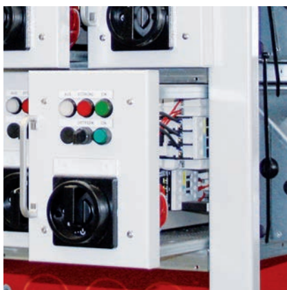
Die Nachrüstung kann bei laufendem Betrieb erfolgen
